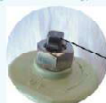
水圧の調整部分
