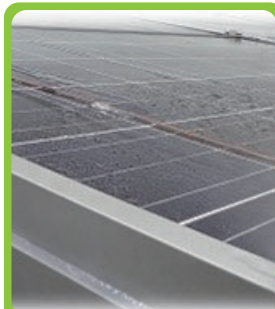
太陽光パネルの噴霧冷却による発電効率アップ
